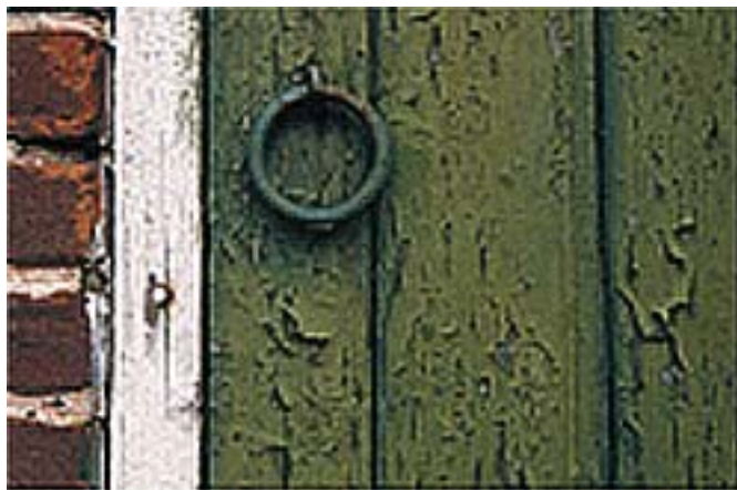
Peeling Door Paint
